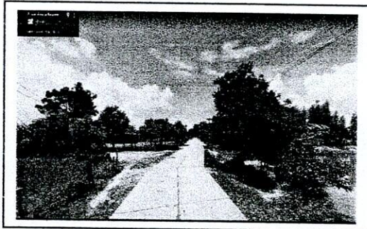
กม.๐+๐๐๐ จุดเริ่มต้น คสล.กว้าง ๔ ม.ไหล่ทาง ๐.๒๐ ม.
